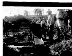
Detalle de un lavadero rústico: agua, paloteadores, canal con trazo o sico y una tina donde se recoge el oro. Mina Santiago, Holguín. Hace dos siglos se viene trabajando así.
